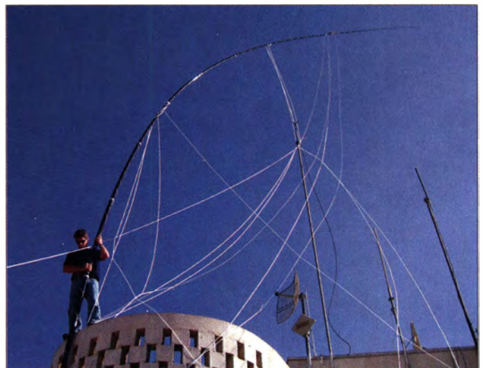
Der Aufbau der 160-m-/80-m-Vertikal auf dem Mittelteil des Hoteldachs nahm mehrere Stunden in Anspruch.
