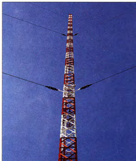
Bild 2: Auf diesem Bild in Richtung Mastspitze ist zu erkennen, dass die obersten Abspannseile nicht mit Isolatoren am Mast befestigt sind.
